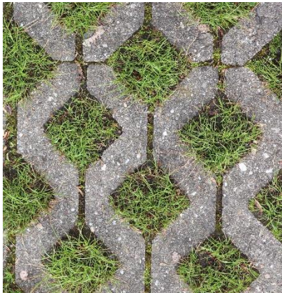
PKW-Stellfläche aus Betongittersteinen und mit Rasen begrünt
