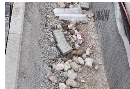
Beispiel für zu wenig Wurzelraum durch Betonkeil, Bauschutt und festgetretenem Boden
