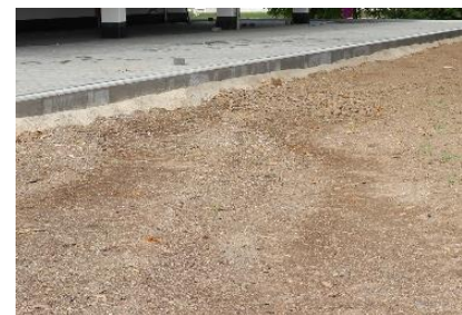
Meistens werden Bodenverdichtungen, wie hier die Fahrspur des Baggers, vor dem Bodenauftrag nicht entfernt, sondern mit Mutterboden überdeckt
